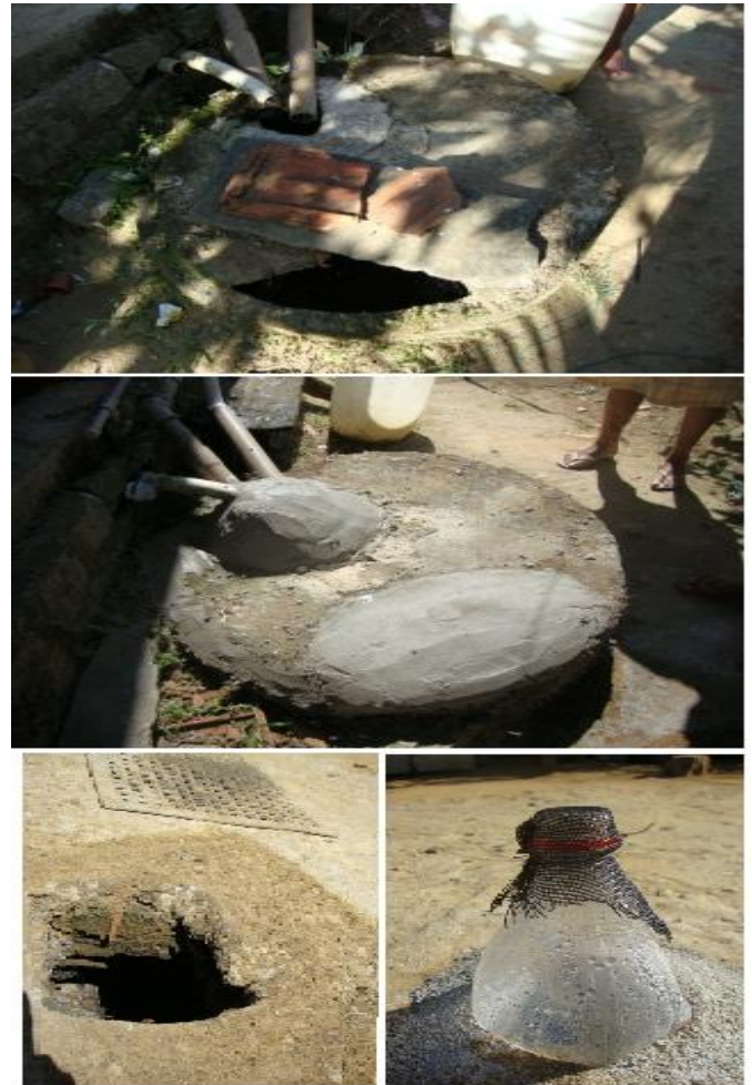
Figura 3. Caso 1- Fossa com dois grandes buracos, tampados posteriormente (acima) e Caso 2 – Suspiro da fossa completamente aberto. Foi criado um suspiro com garrafa PET e a boca tampada com tela e arame (abaixo).
